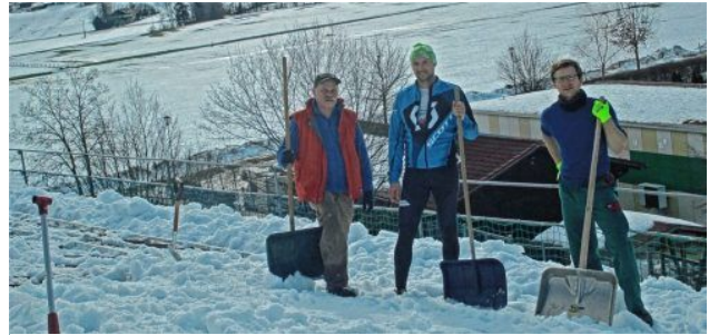
BEC-Vorstandsmitglied Georg Beyschlag , Ulrich Unterforsthuber von der Firma Abel-ReTec und BEC-Vorstandsvorsitzender David Schmidner (von links) sorgten mit ihrer Schneeräumaktion dafür, dass alle PV-Module auf dem Bernauer Turnhallendach rechtzeitig installiert werden konnten, damit die Anlage vor Jahresende in Betrieb gehen und so die höhere Einspeisevergütung noch gesichert werden konnte. FOTO LEIDEL
