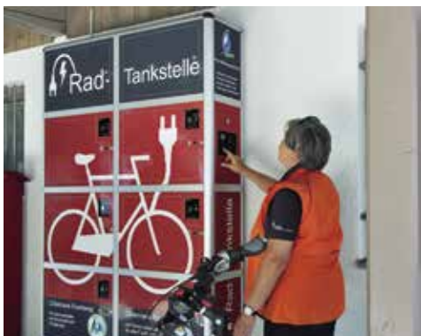
Bedienung der öffentlichen E-Rad-Ladestation
